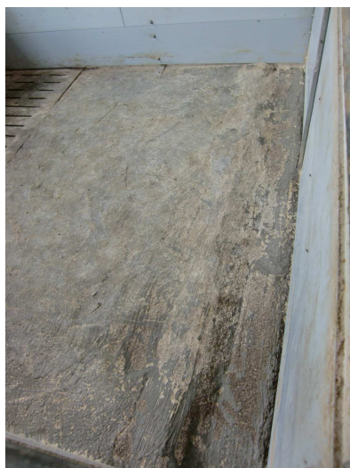
Slika 8: Neustrezna izvedba betonskih tal
