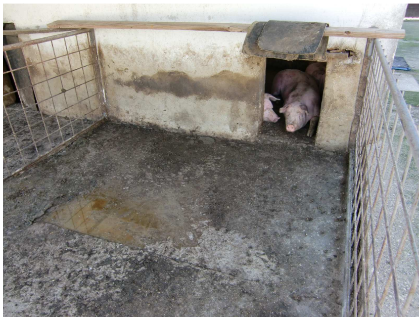
Slika 10: Močna obraba polnih betonskih tal na izpustu s povečano nevarnostjo za poškodbe prašičev in ljudi
