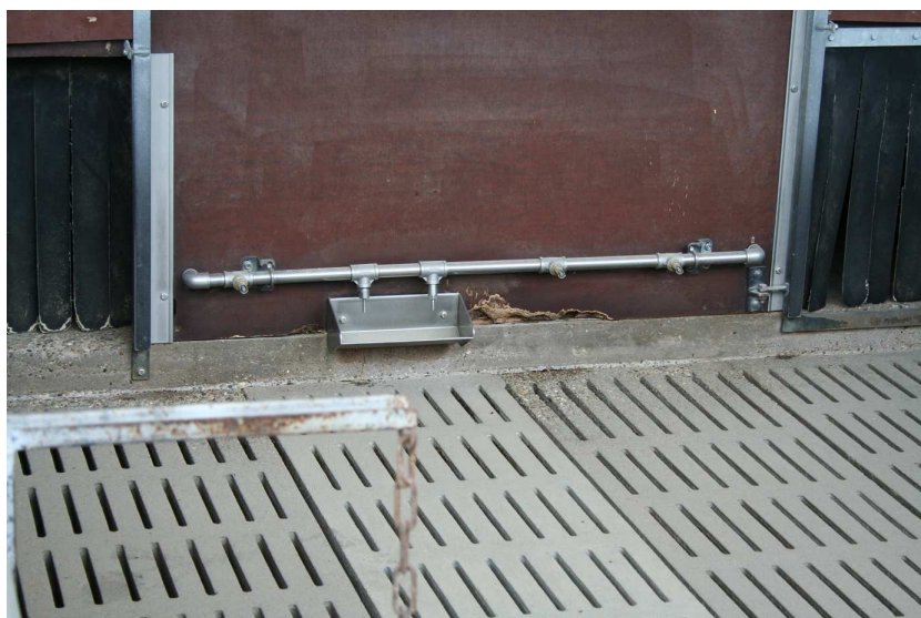
Slika 9: Obraba betonskih rešetak pod napajalniki
